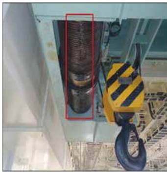
기관실 OVERHEAD CRANE(P) L.O DROP 위치
