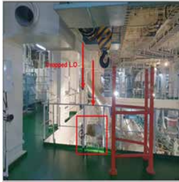
기관실 순찰 중 발견한 OVERHEAD CRANE(P) 위치
